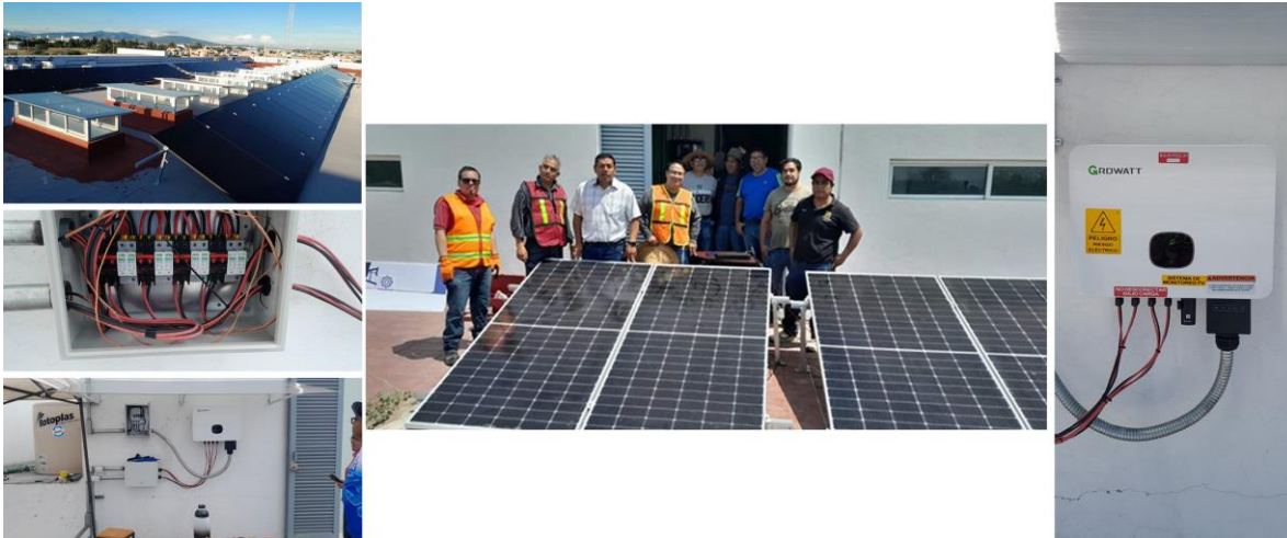
Ilustración 14. Implementación de Sistema Fotovoltaico en Campus 2.
