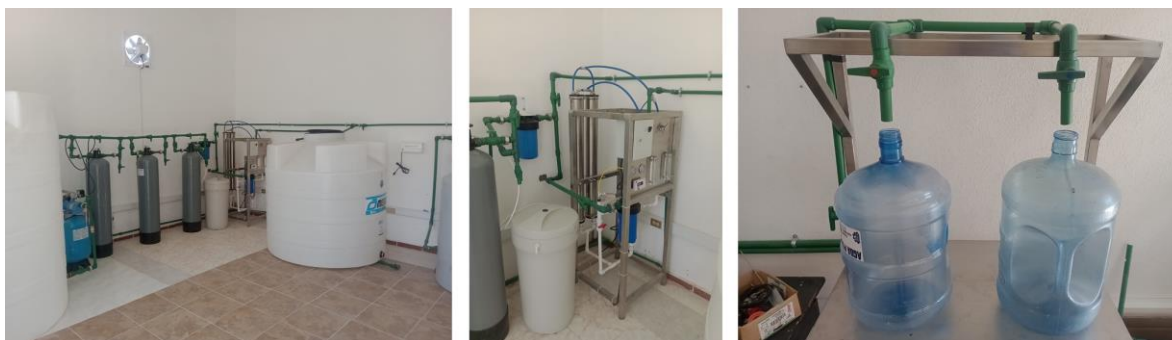
Ilustración 25. Desarrollo de planta purificadora de agua.
